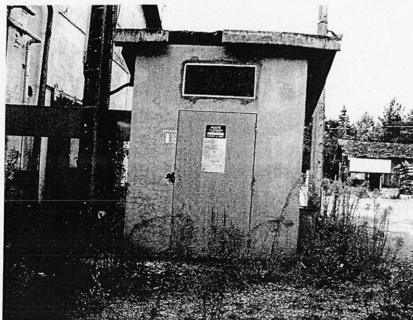
Figure 5 : Transformateur à côté du bâtiment 28 - 2005 avant pillage
